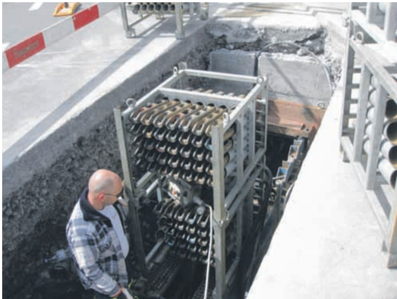
Eine kleine Baustelle am Anfang und eine am Ende: Innert zwei Tagen wurden an der Samstagernstrasse mit dem Schneid-Zieh-Verfahren 140 Meter einer Hauptwasserleitung ersetzt, ohne die Strasse durchgehend zu öffnen.
